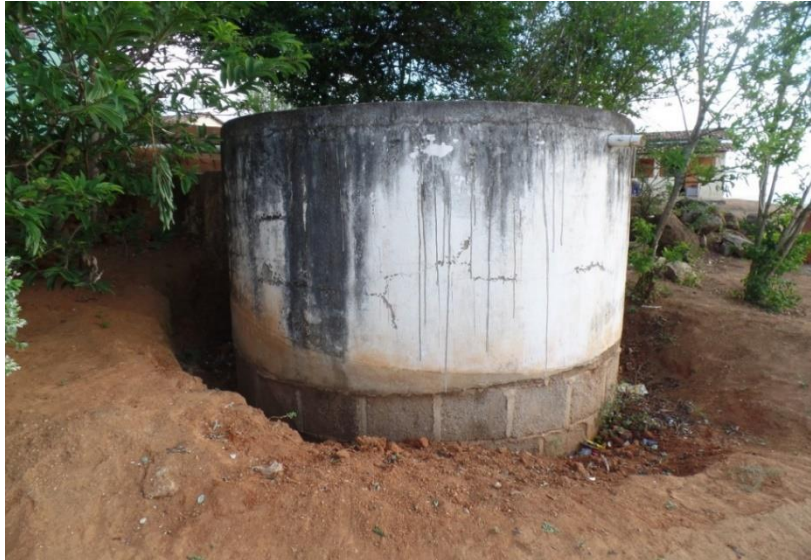
Figura 04: Cisterna próxima a residência no Grilo
