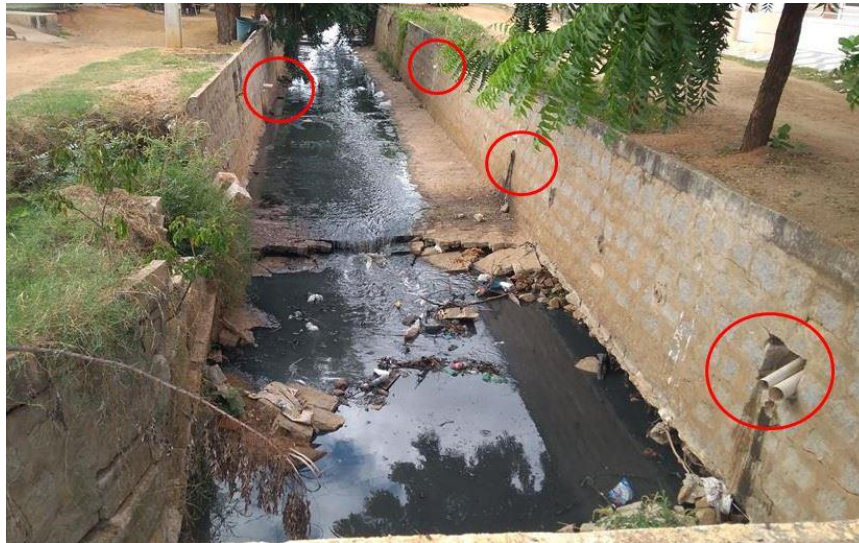
Imagem 3. Ligações clandestinas de esgotos domésticos no sistema de drenagem pluvial.
