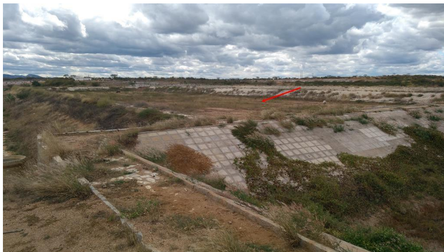
Imagem 2. Serviços de impermeabilização no fundo das lagoas facultativas inacabados.
